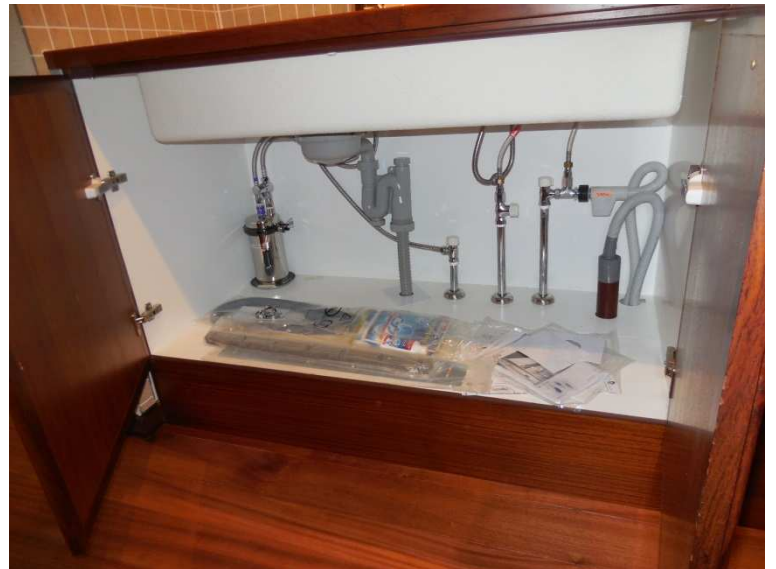
シンク下の配管状況。
