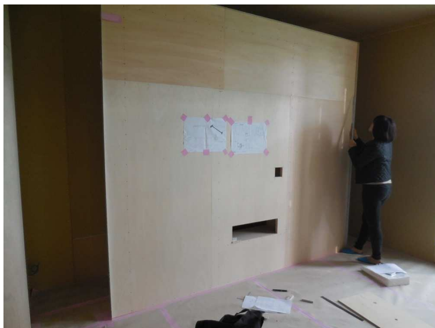
壁掛け TV 用タイル壁下地状況。
