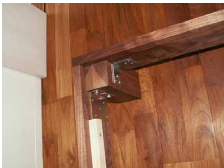
フットボードとサイドレールの固定状況 脚 100 角は 2 枚剥ぎ
