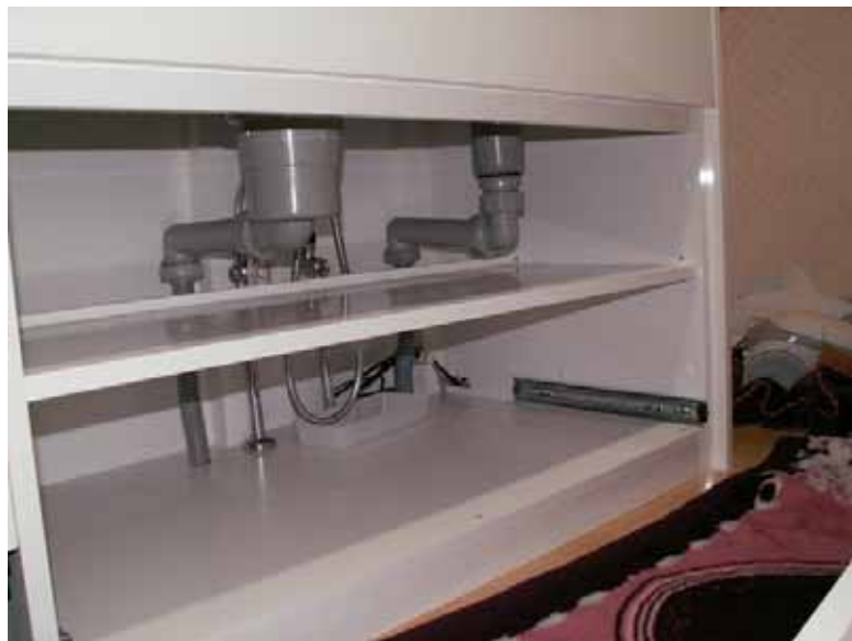
シンク排水管状況。
