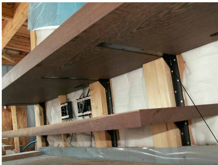
ブラケット固定状況です。 ブラケットはザグリ部にうまく納まっています。 ***このザグリとコンセント穴はNC加工です。
