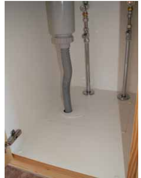
内部配管状況。
