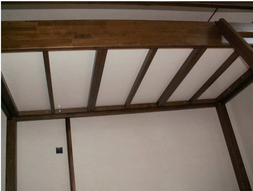
2 段目畳下床パネル貼り、受け枠にビス固定し、強度を図る。
