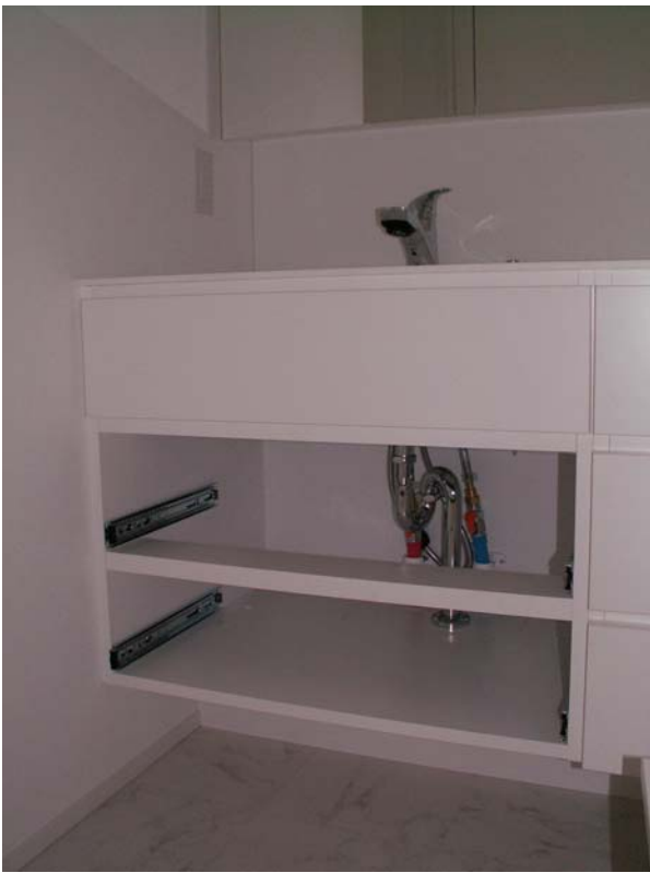
配管状況です。
