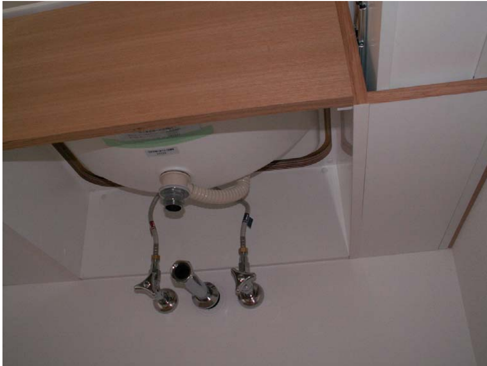
洗面台ボウル部の状況です。
