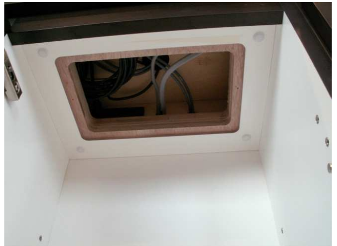
オーディオコントロールパネル下の配線口。
