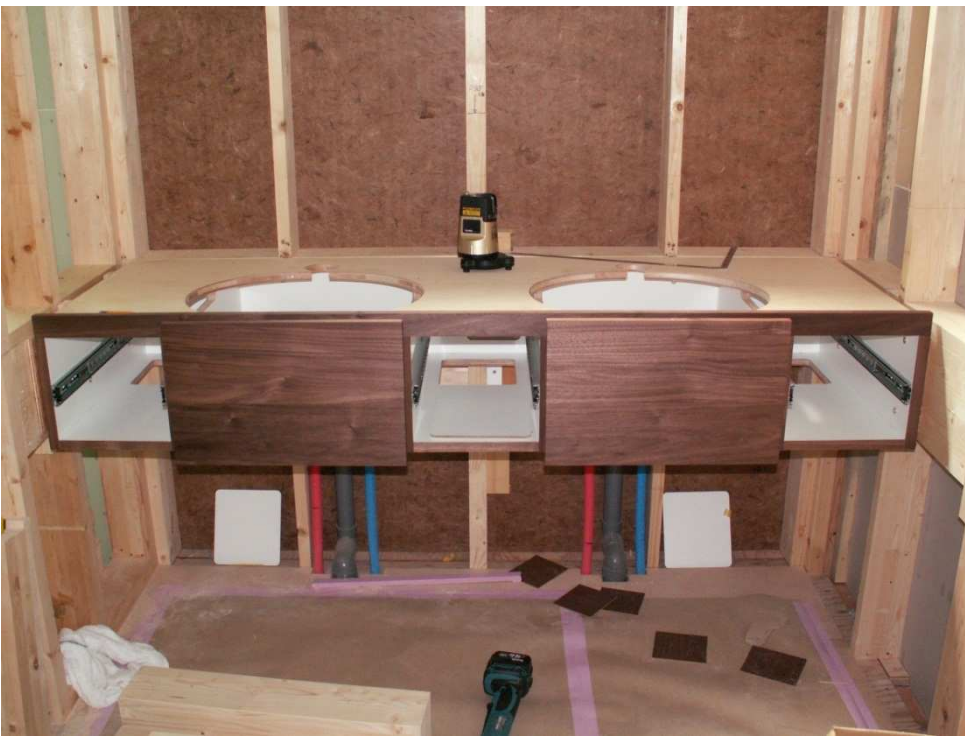
ボックス固定状況。中央引出し内部でブラケット支持にて撓み防止を図る。
