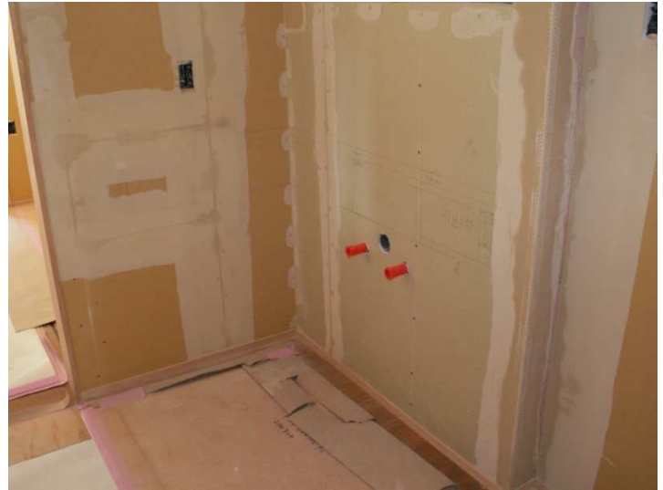
今回はフカシ壁完了後、クロス貼りの 後、洗面台を取り付けます。
