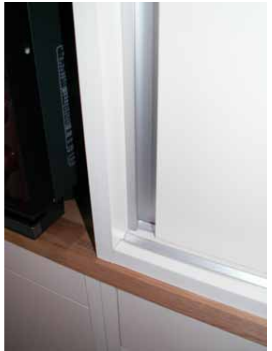
引き戸アルミレール状況
