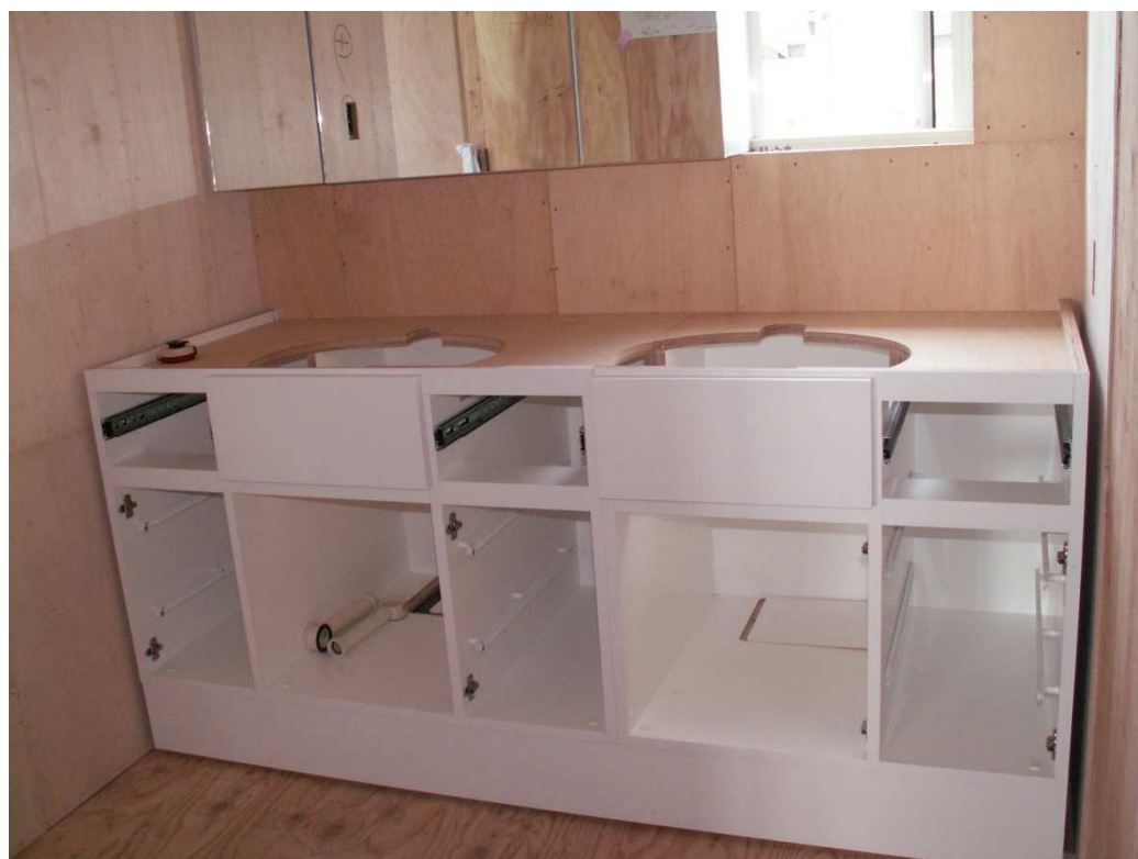
三面ミラー収納を取り付け、カウンター部箱組完了、人大天板セット前の状況。
